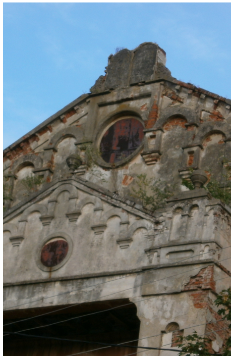
Rysunek 33. Tablice Mojżeszowe w pozycji górującej na pozostałościach synagogi w Drohobyczu (Ukraina) [dokumentacja z roku 2013]. Obecnie synagoga jest odnowiona.
