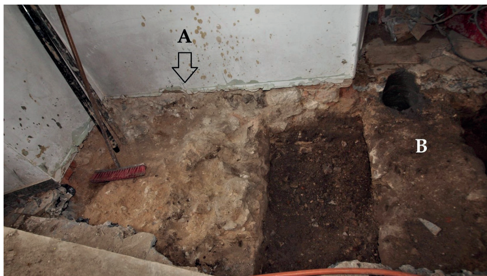
II. 6. Widok skutych koron muru północnego (oznaczony strzałką A) oraz równoległego do niego muru wtórnie dostawionego (B), fot. Anna Bojęś-Białasik (2018).
